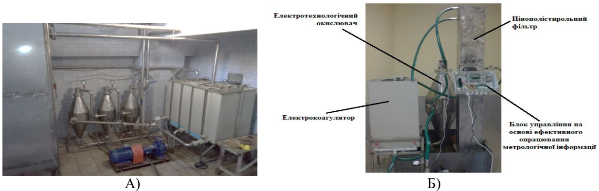
Рис. 2. Зовнішній вигляд автоматизованого комбінованого електротехнологічного водоочисного обладнання (СБВ) на промислових об'єктах: А – м'ясопереробка, Б – мала металургія
