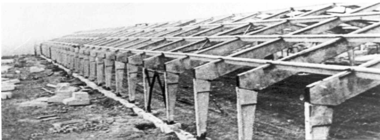
Будівництво сільськогосподарських виробничих будинків з складених залізобетонних рам РЖС прогоном 21м /к. Кримський Облміжколгоспбуд /
