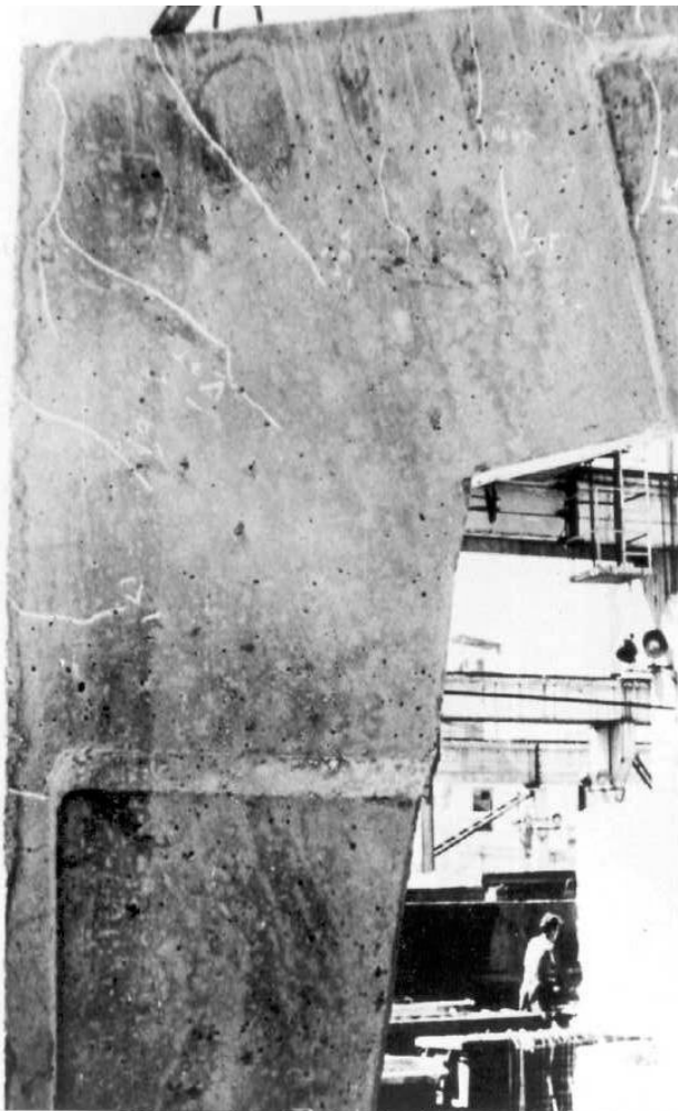
Рис.3.21. Розвиток тріщин в карнизному вузлі
