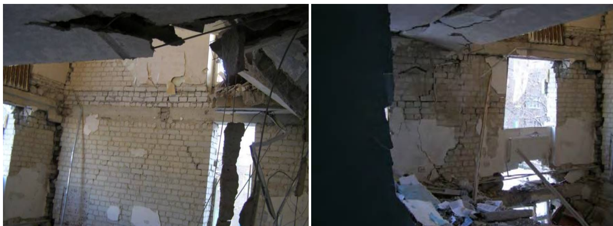
Рисунок 10. Обрушены перекрытия над вторым и третьим этажом.
