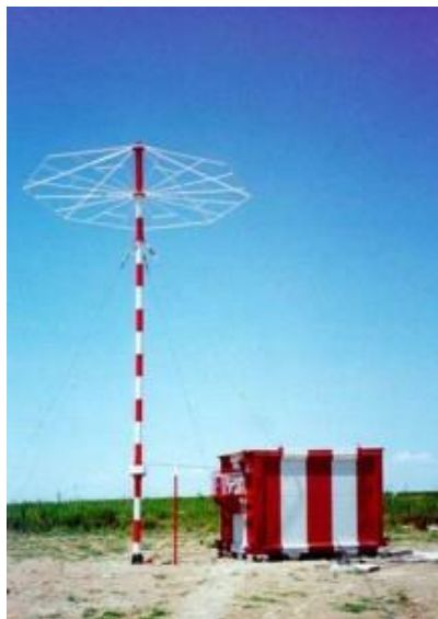
Рис. 3.3. Неспрямований радіомаяк (NDB (non-directional beacon))
