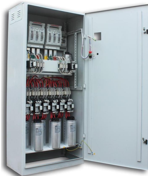
Рис. 3.4. Комплексна конденсаторна установка з комутаційно-захисною апаратурою та можливістю автоматичного регулювання реактивної потужності
