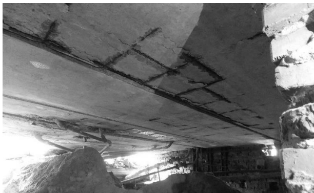
Рис.4. Пошкодження захисного шару бетону, оголення і корозія арматури
