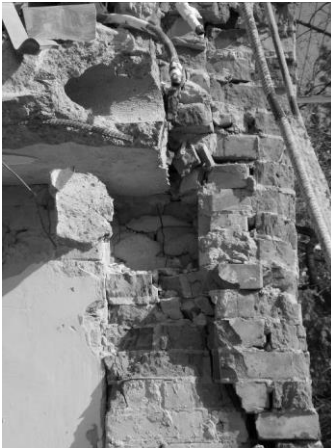
Рис. 2. Пошкодження кладки у зоні руйнування
