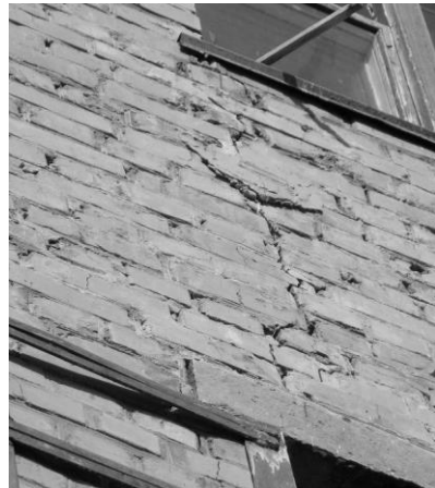
Рис. 3. Наявність старих тріщин у зовнішніх стінах
