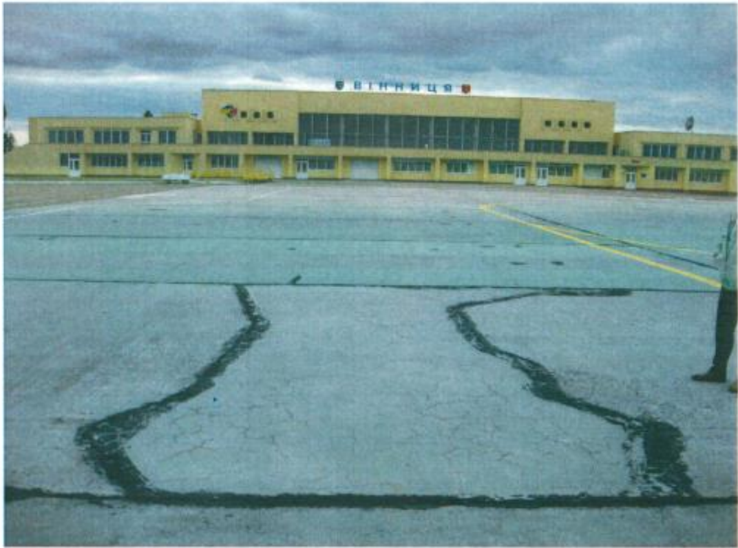
Рис. 4.7 – Повздовжні тріщини покриттів перону
