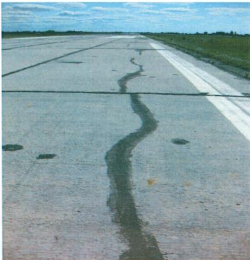
Рис 4.3 – Повздовжня тріщина ШЗПС
