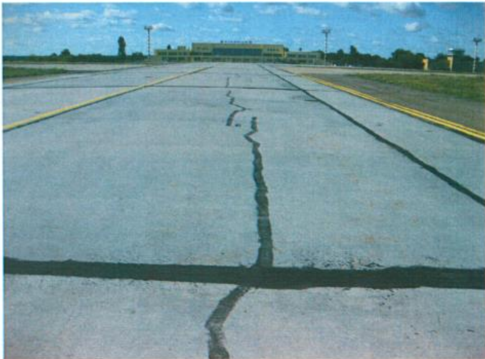
Рис. 4.8 - Повздовжні тріщини покриття РД-3
