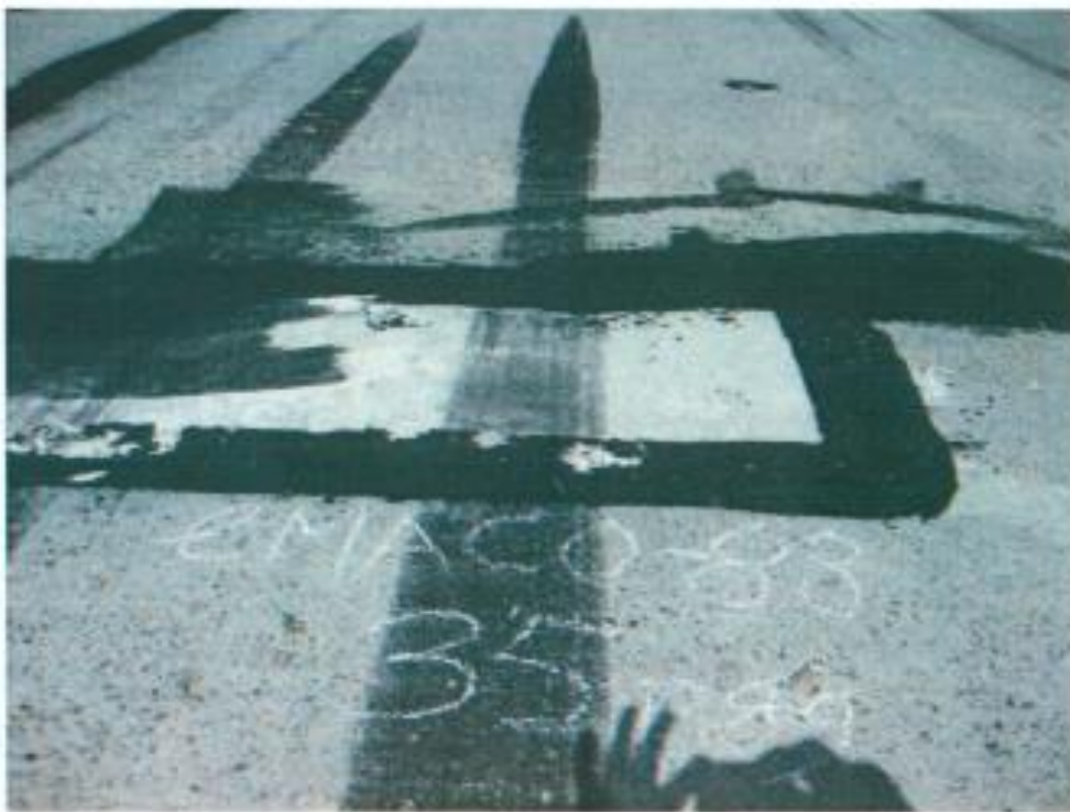
Рис. 4.9 – Лущення бетонної поверхні ШЗПС
