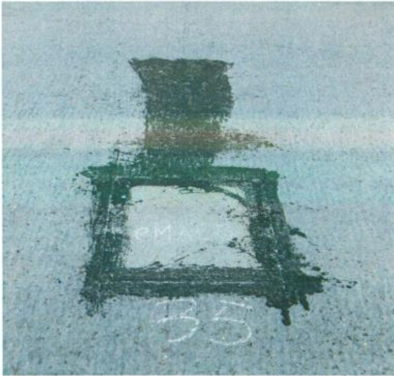
Рис. 4.4 – Лущення поверхні плит
