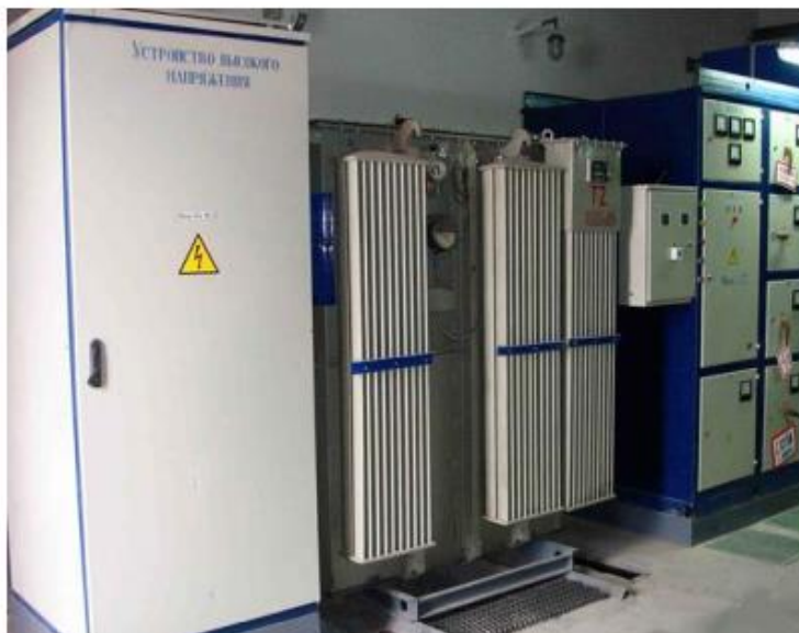
Рисунок 1.2 – Зовнішній вигляд комплектної трансформаторної підстанції
