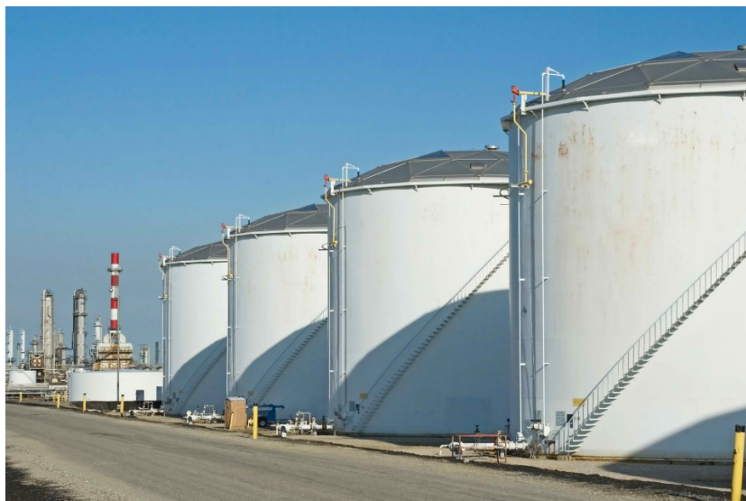
Рис. 1.1. Зовнішній вигляд резервуарів на складі зберігання палив
