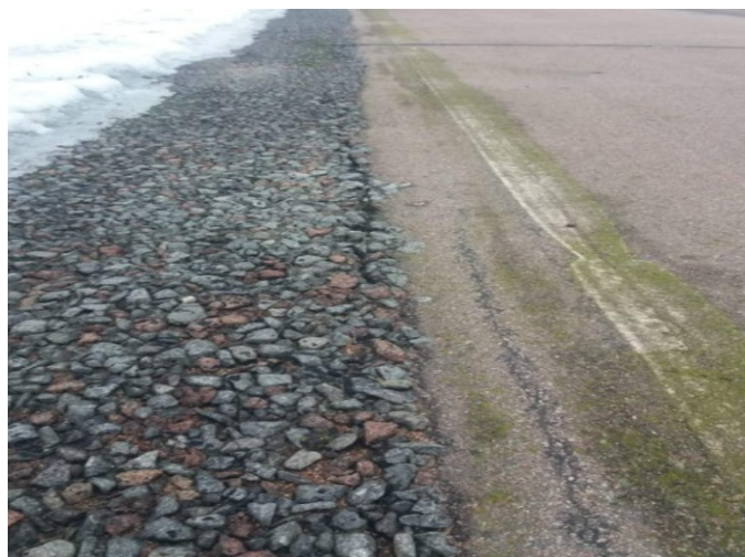
Рис. 13.3. Дефекти щебеневого вимощення асфальтобетонного аеродромного покриття
