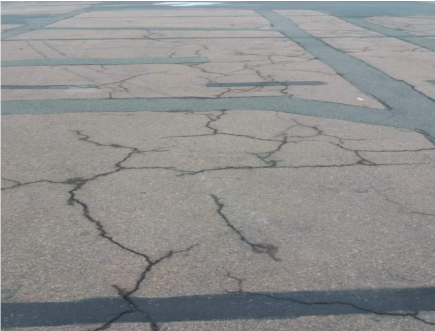
Рис. 13.2. Сітка тріщин асфальтобетонного аеродромного покриття
