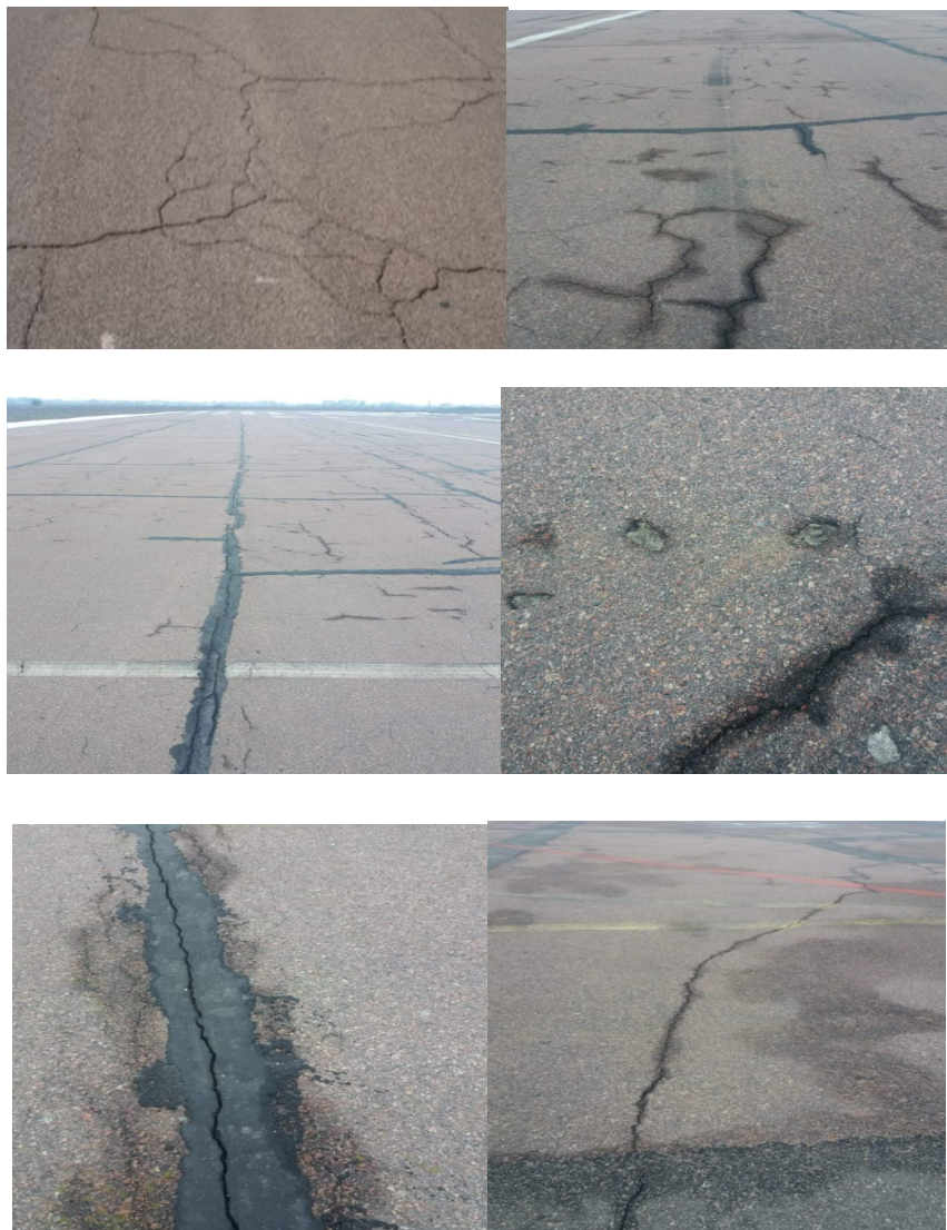
Рис. 13.1. Дефекты асфальтобетонного аэродромного покрытия
