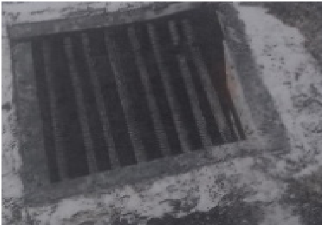
Рис. 14.1. Дефекти кришки дощеприймального колодязя на аеродромі
