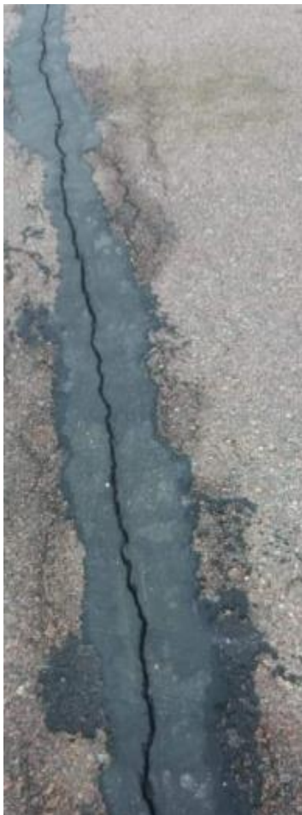
Рис. 2.2. Пошкодження аеродромного покриття ЗПС аеродрому І-А класу
