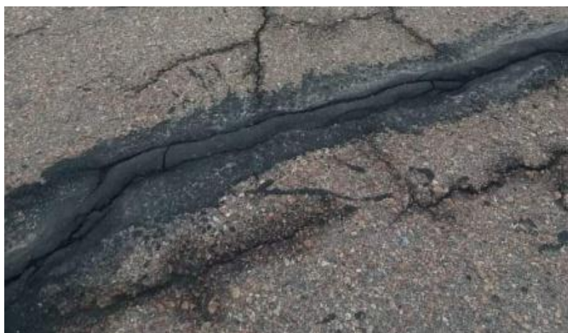
Рис. 2.1. Пошкодження аеродромного покриття ЗПС аеродрому I-A класу
