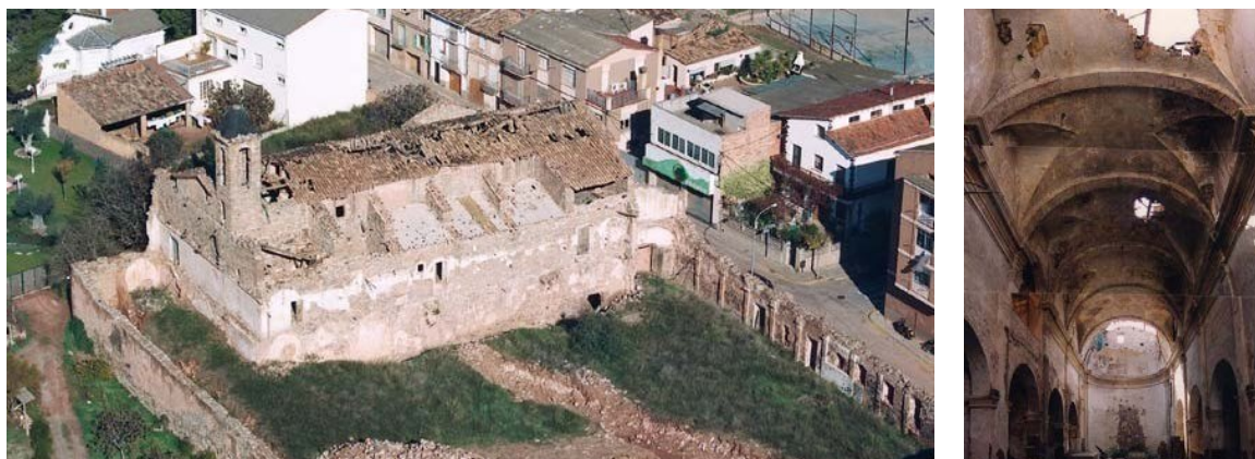
Рис. 1.16. Зруйнована церква до реконструкції
