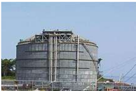
Бак для зберігання СПГ в EG LNG
