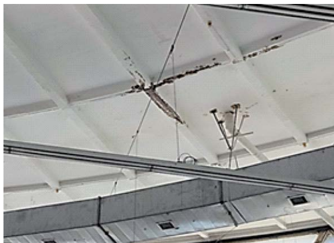
Рисунок 11 – Корозія елементів стику плит покриття
