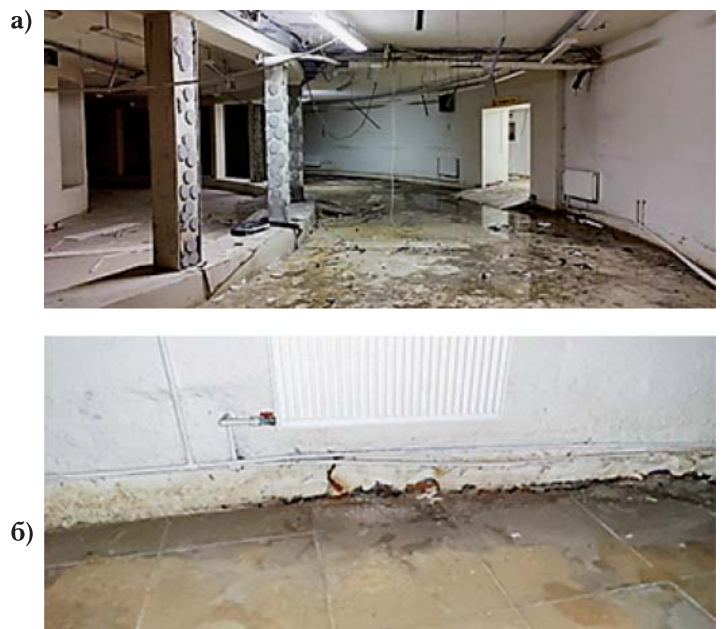
Рисунок 13 – Дефекти конструкцій підвалу: а – аварійне залиття водою з сантехнічних систем; б – просідання ґрунту під підпірною стіною коридора
