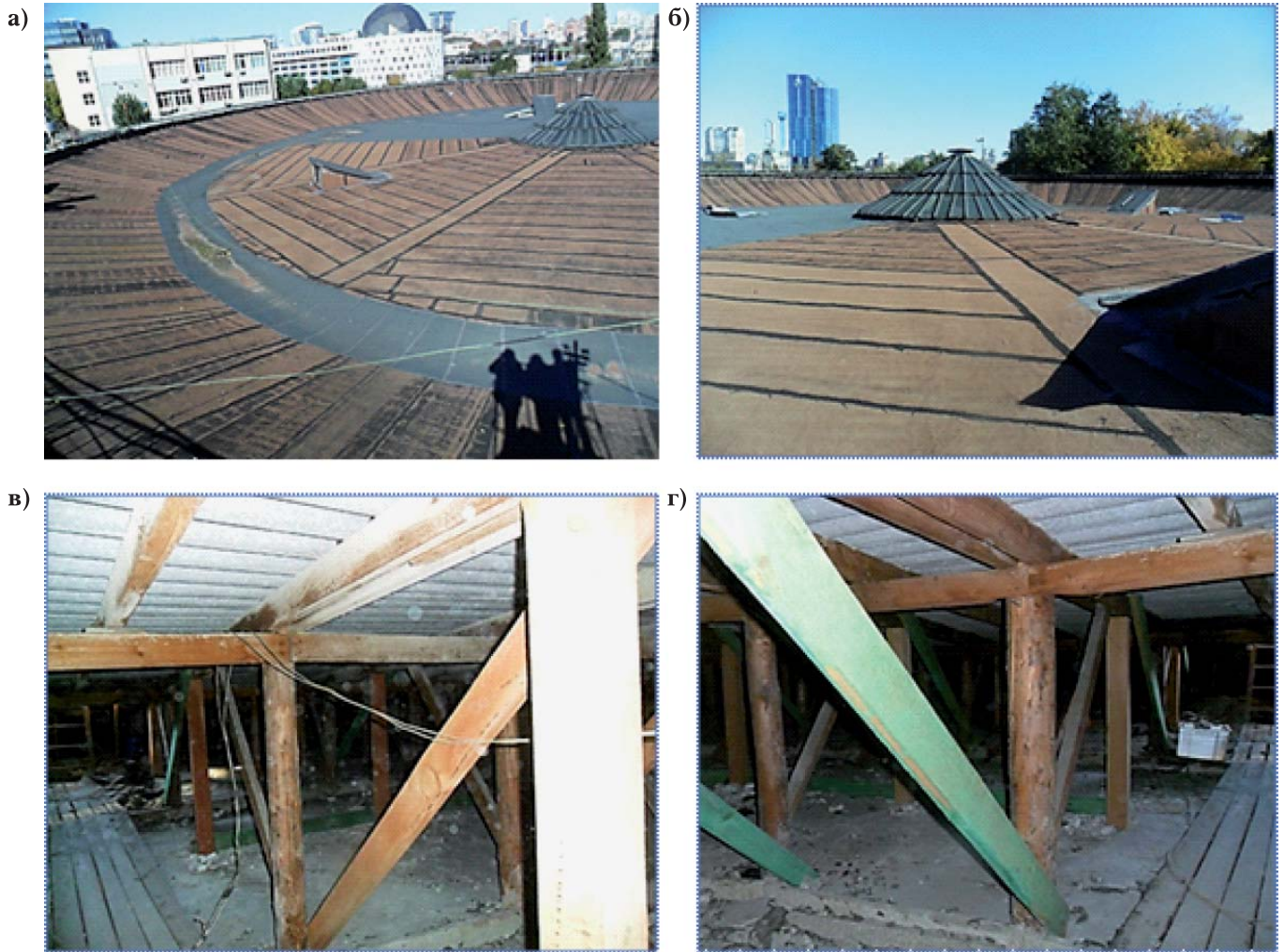
Рисунок 12 – Технічний стан покрівлі: а, б – вид ззовні; в, г – горище, крокви
